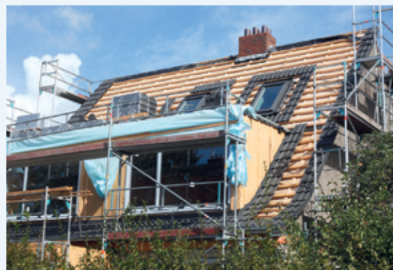
Luftdichtheit im Bestand bietet ebenfalls großes Potenzial zur Bauschadenvermeidung und Energieeinsparung
